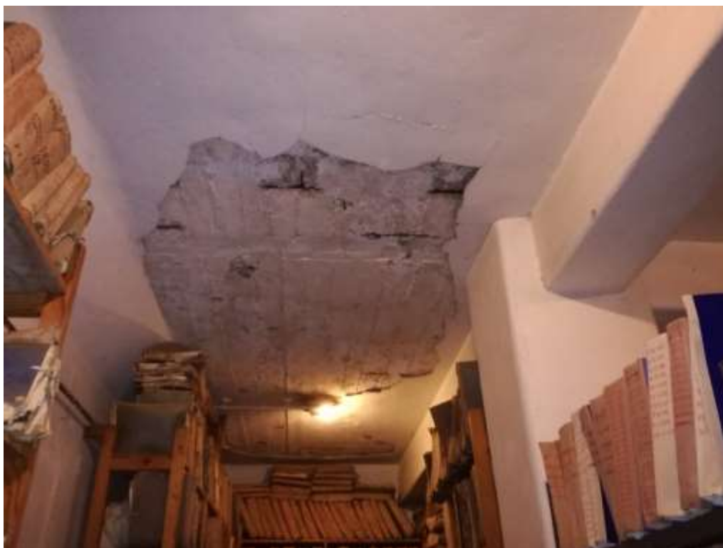
Εικόνα 44 – Αποκάλυψη ράβδων οπλισμών στο υπόγειο – ΚΤΙΙ
