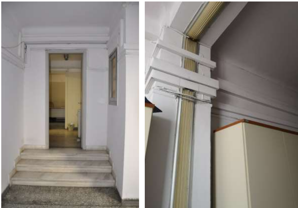
Εικόνα 38 – Ανισοσταθμία στο δάπεδο του 5 ου όροφου ΚΤΙ και αρμός διαστολής
