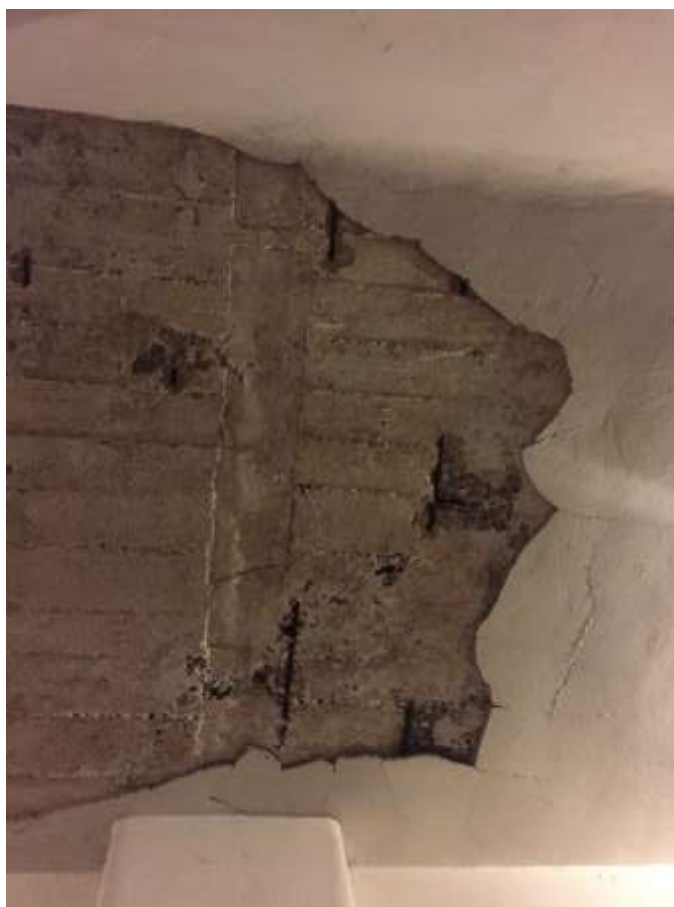
Εικόνα 47 – Ράβδοι οπλισμού (δεσμίδες) στην οροφή υπογείου στο ΚΤΙΙ, οξείδωση οπλισμού
