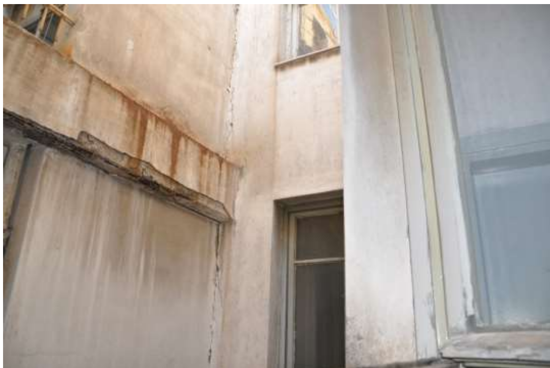
Εικόνα 48 – Αποκάλυψη οπλισμού στο ΚΤΙΙ
