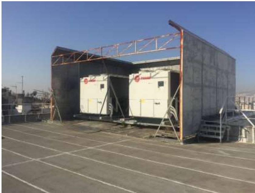
Εικόνα 58 – Περιοχή μηχανολογικού εξοπλισμού – ΚΤΙ
