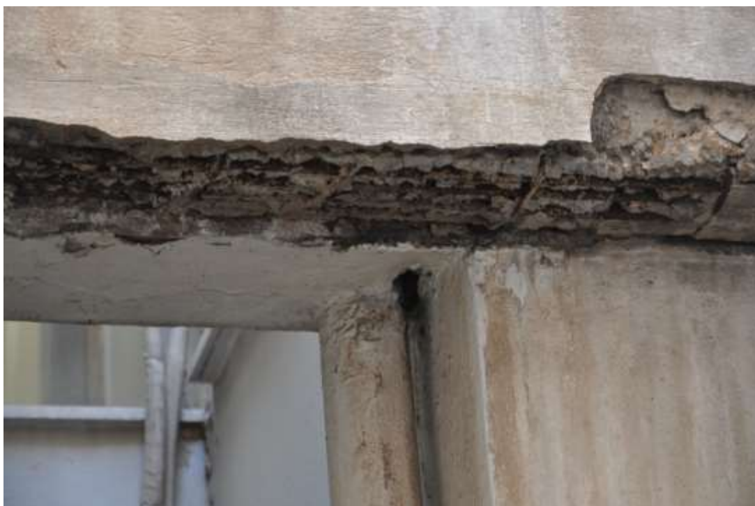
Εικόνα 45 – Αποκάλυψη ράβδων οπλισμών στην παρειά του ΚΤΙΙ, οξείδωση οπλισμού
