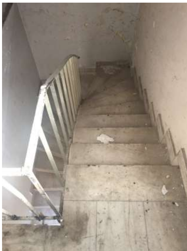
Εικόνα 49 – Επιφανειακές φθορές δευτερεύον κλιμακοστάσιο ΚΤΙΙ
