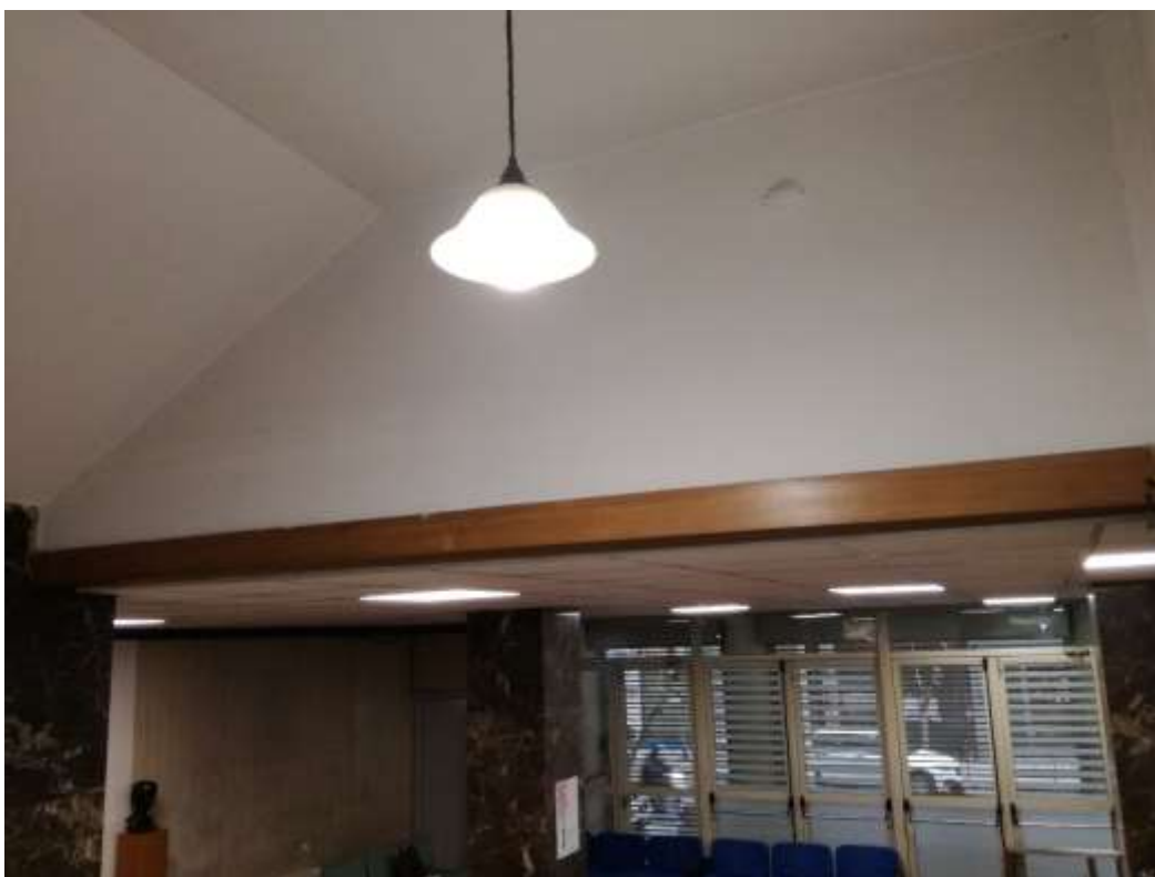
Εικόνα 16 – Δοκός ισογείου με τοίχιο στις ανώτερες στάθμες - ΚΤΙΙ
