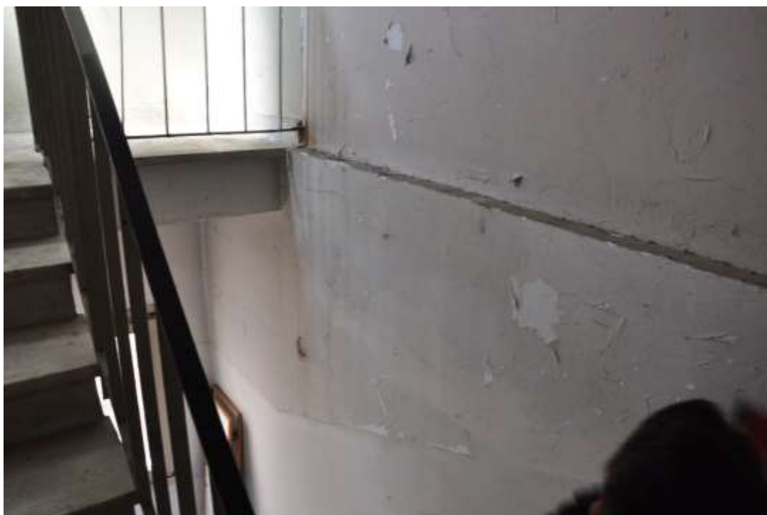
Εικόνα 50 – Επιφανειακές φθορές δευτερεύον κλιμακοστάσιο ΚΤΙΙ
