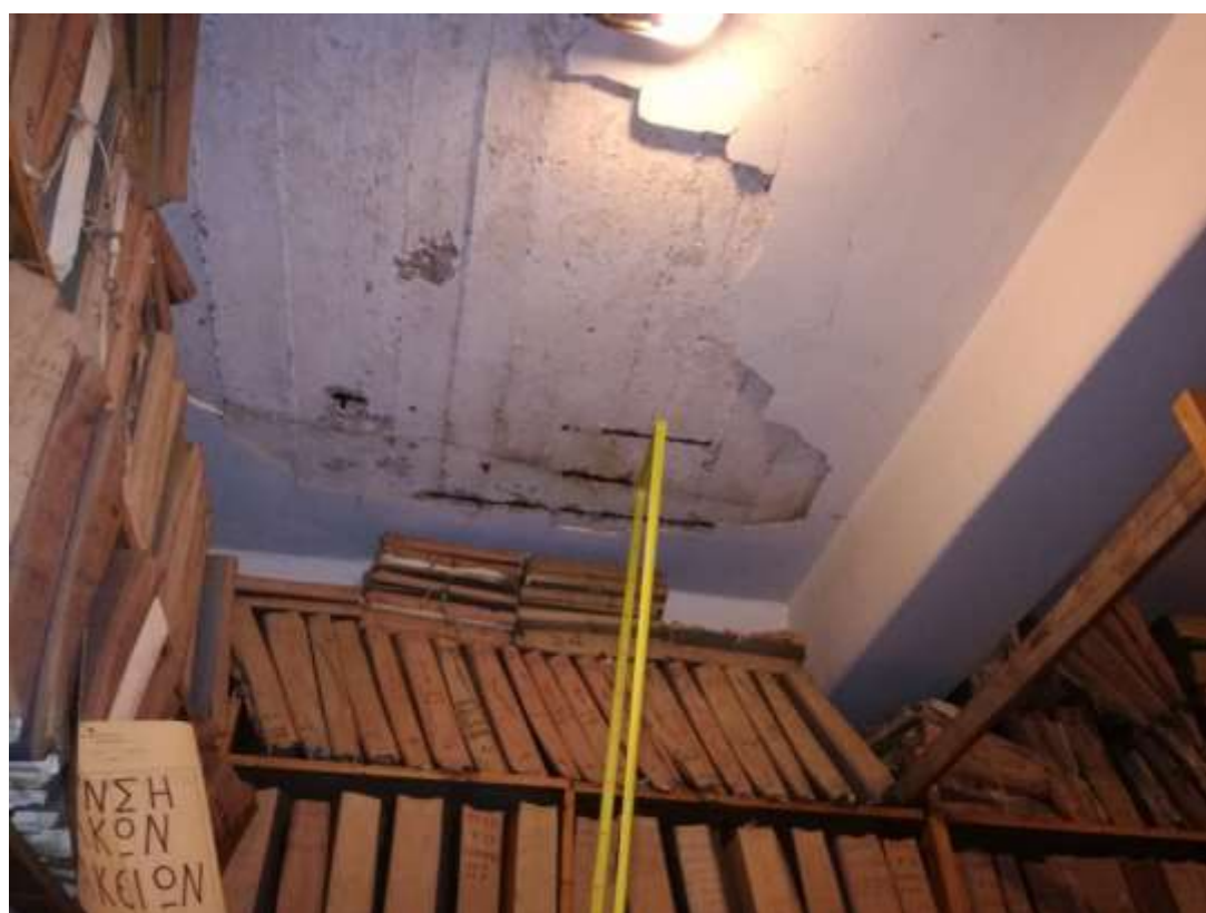
Εικόνα 46 – Ράβδοι οπλισμού (δεσμίδες) στην οροφή υπογείου στο ΚΤΙΙ, οξείδωση οπλισμού
